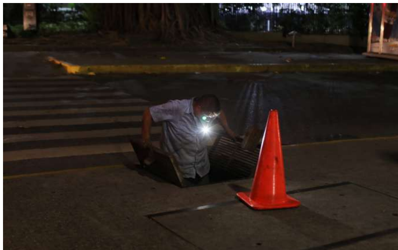
Un employé de Corpoelec, la société d'électricité d'Etat, vérifie un câble, à Caracas, le 11 mars. STRINGER / REUTERS
